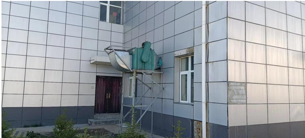
油烟净化器+油烟排气烟道
